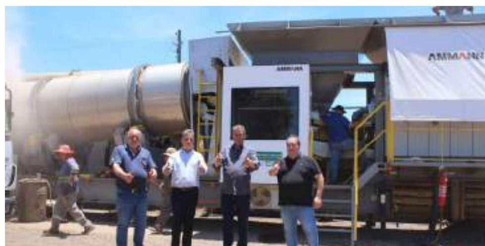
Os prefeitos Marco Antonio Sana e Edson Luiz Rossatto, ladeados pelos vice-prefeitos Valmir Bocalon e Fabiano Luiz Klein, acompanharam a produção do asfalto na usina e também a reperfilagem sendo realizada em Sertão
