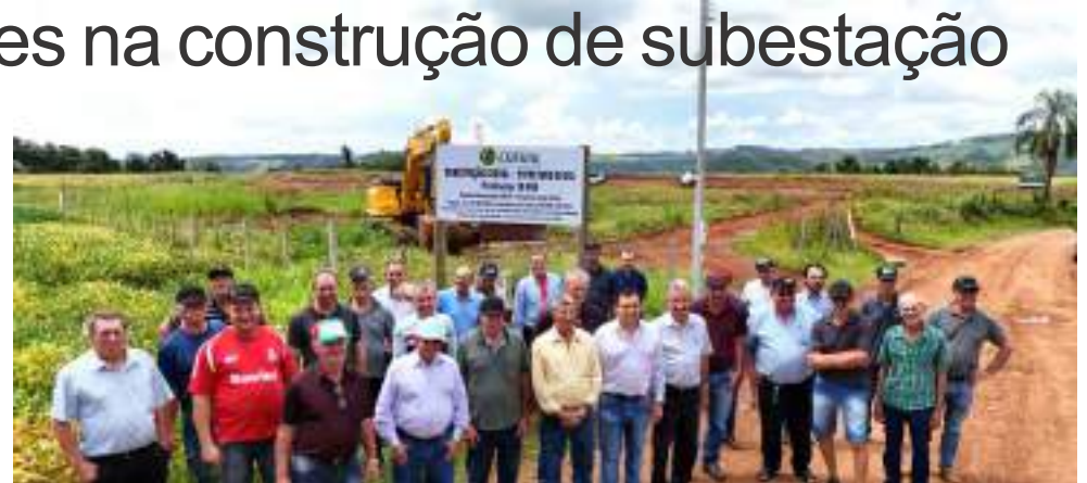
Direção e líderes da Creal no canteiro de obras da primeira subestação da cooperativa
